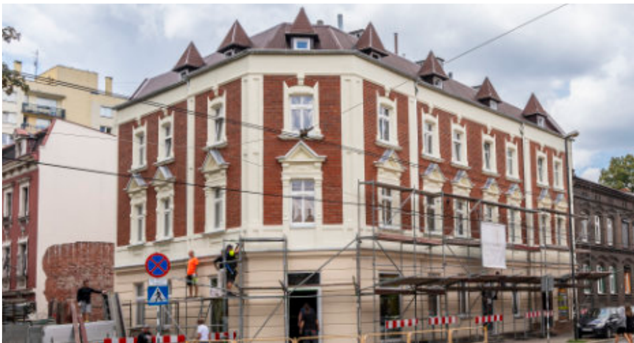
► Z kamienicy przy ul. 3 Maja 71 znikają wykorzystywane podczas remontu rusztowania Fot. UM Zabrze
