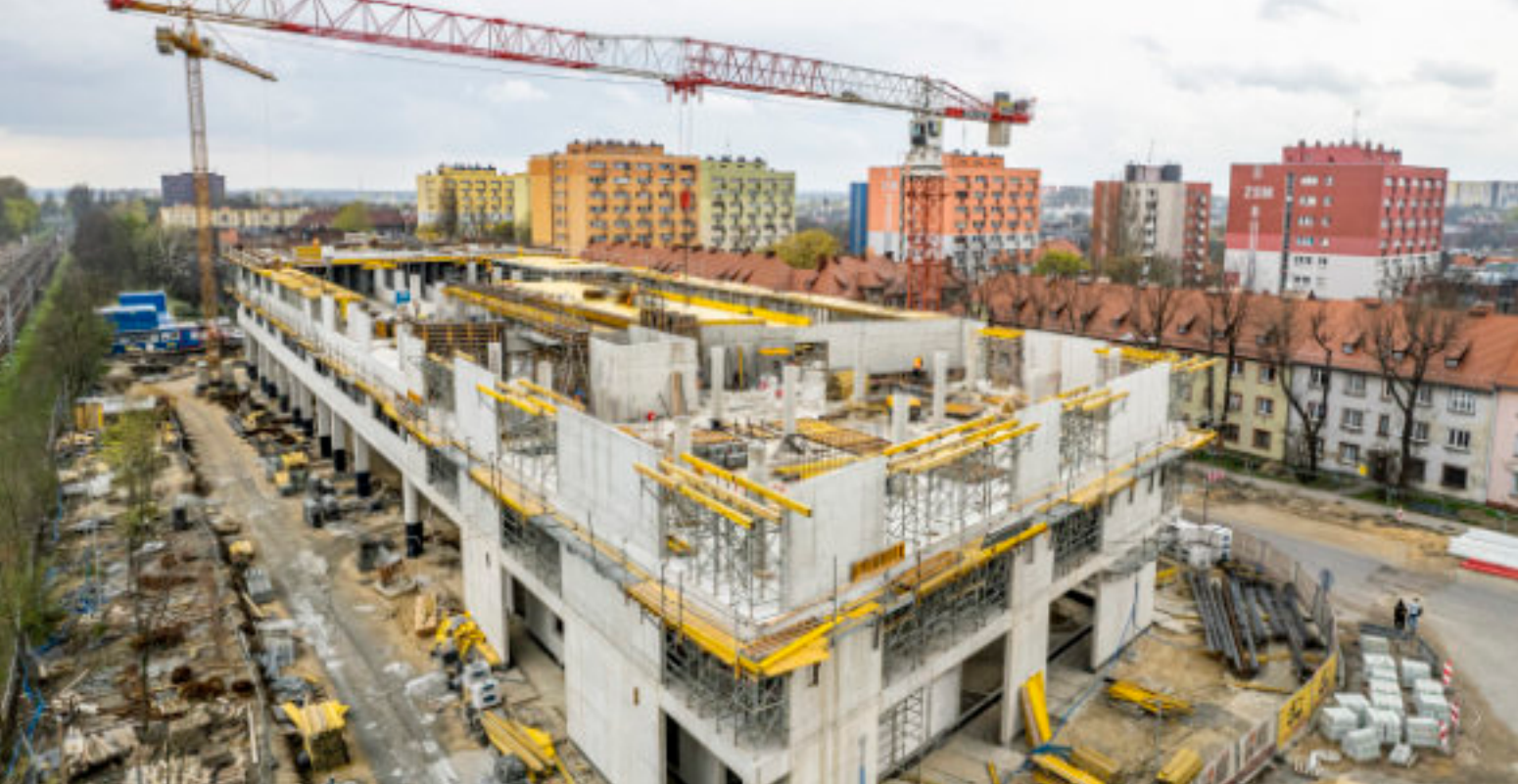
► W szybkim tempie postępują prace na budowie centrum przesiadkowego przy ul. Goethego Fot. UM Zabrze
