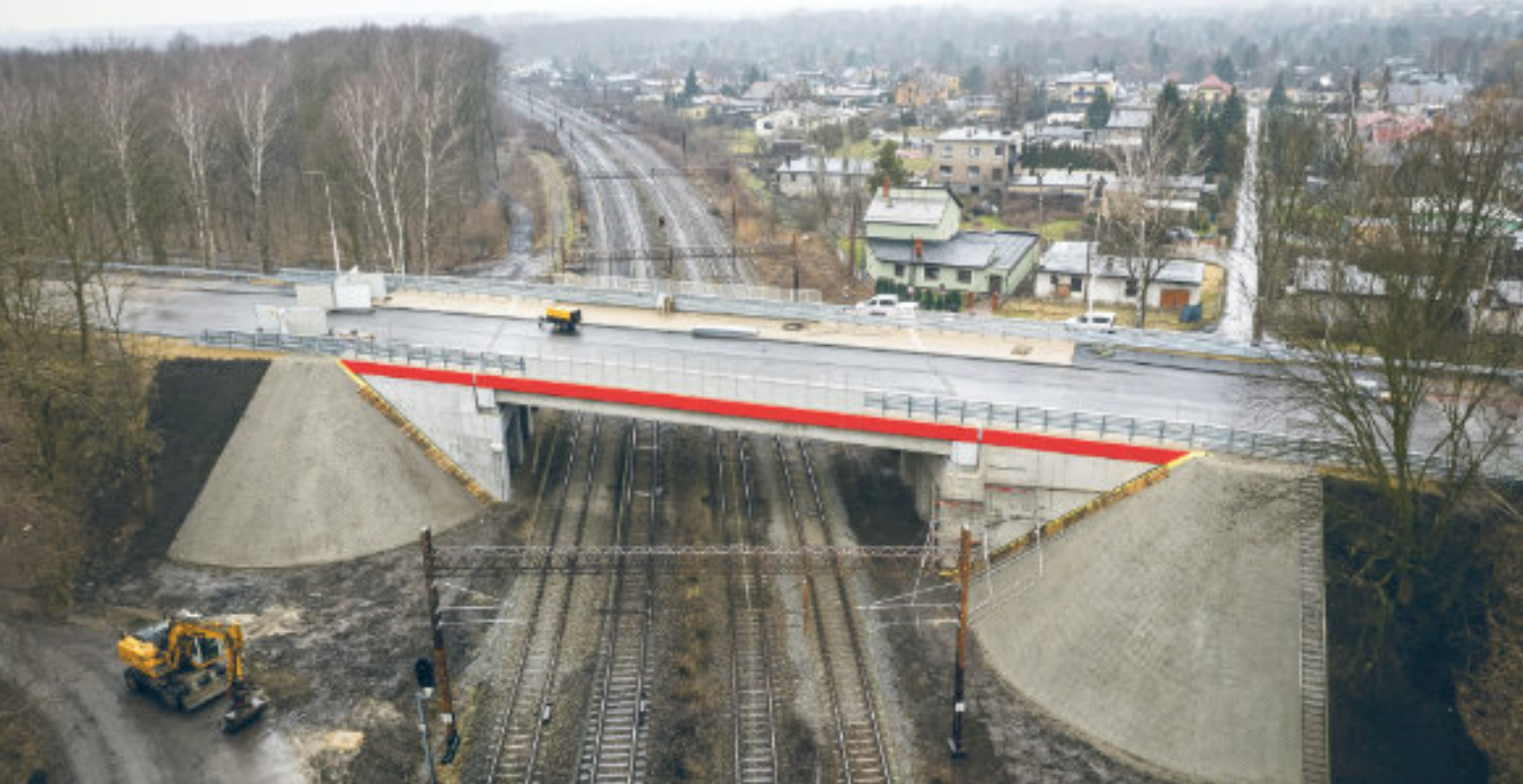
► Zakończył się remont wiaduktu nad torami kolejowymi w ciągu ul. Roosevelta Fot. UM Zabrze
