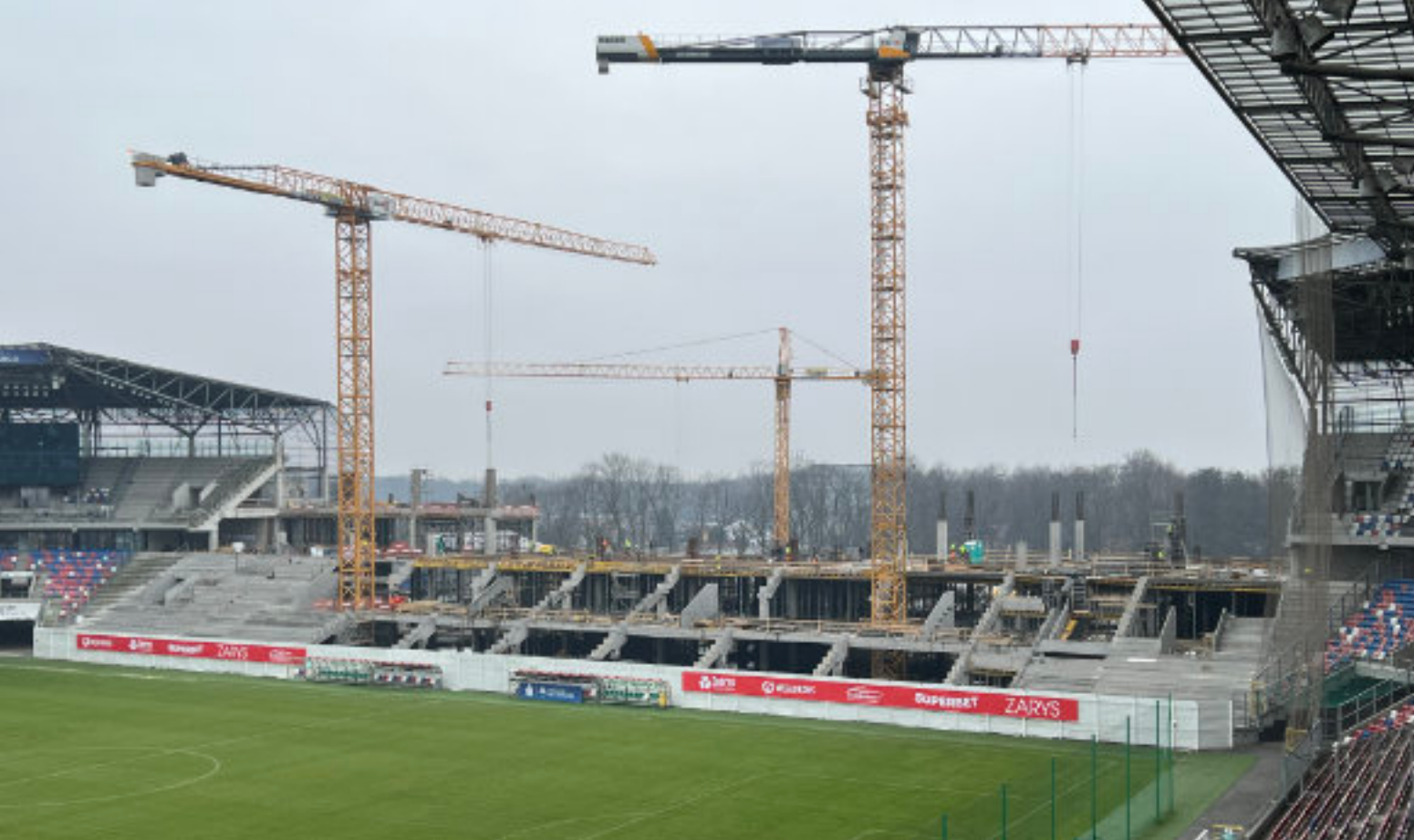
► Na budowie czwartej trybuny Areny Zabrze trwają intensywne prace Fot. Arena Zabrze
